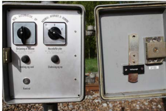
Fig. 10.14. B1 Betjeningskasse - bomanlæg
