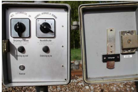
Fig. 10.14. B1 Betjeningskasse - bomanlæg
